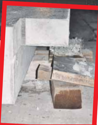
Das umgefallene Betonteil war nicht ausreichend durch Bolzen gesichert.
