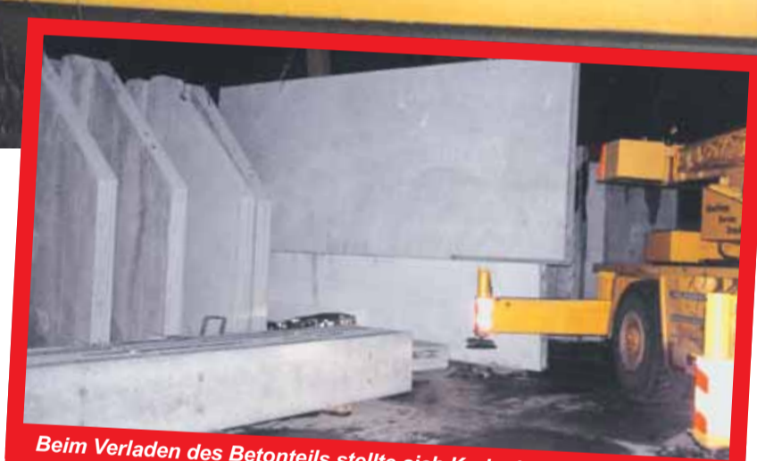
Beim Verladen des Betonteils stellte sich Karim in den Gefahrenbereich zwischen die Platten und wurde dort tödlich verletzt.
