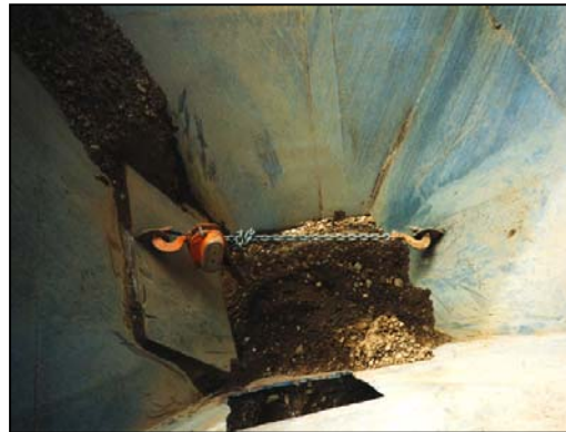
▲ Als der Mitarbeiter diese Spannvorrichtung einbaute, kippte sein Kollege nichtsahnend eine volle Ladung Steinmaterial ins Silo. Der Mitarbeiter wurde verschüttet und starb.
