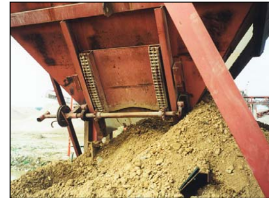
▲ Er bestieg das Silo durch diese Öffnung. Weder hatte er dafür die Erlaubnis, noch informierte er die Kollegen, noch machte er kenntlich, dass er sich dort aufhielt.
