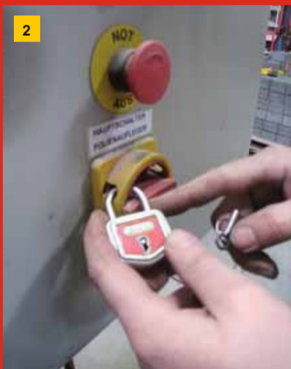
2 Sichern Sie den Hauptschalter gegen Wiedereinschalten mit einem Vorhängeschloss.
