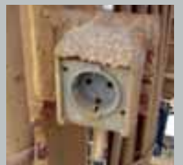
Nanu, wo ist denn hier der Klappdeckel geblieben? Ohne den wird die Steckdose bei nassem Wetter zur lebensgefährlichen Stromquelle. Deshalb: Nicht lange fackeln – sofort ersetzen!
