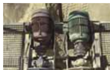
Die Antriebe der Befeuchtungsanlage rechts und links. Hier arbeitete Carlos bei laufendem Antrieb.
