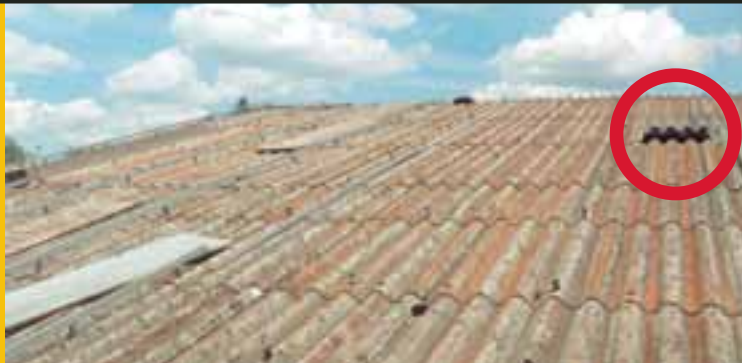
Oben rechts zu erkennen: das rausgebrochene Lichtelement, die Falltür in den Tod
