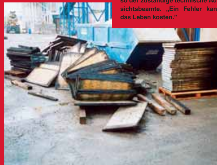
Die Schalungsbretter fingen Feuer und sorgten für eine schnelle Ausbreitung des Brandes.
