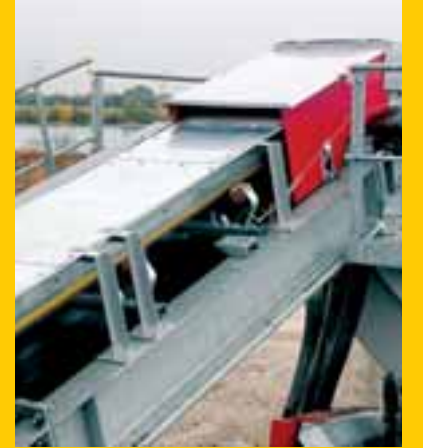
Überdecktes Band am Brecherabzug mit Abdeckung der Antriebstrommel
