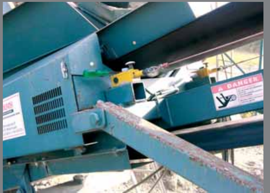
Gefährliche Manipulation: Mittels eines Schraubenziehers wurde hier der Reißleinschalter vorübergehend festgesetzt.
