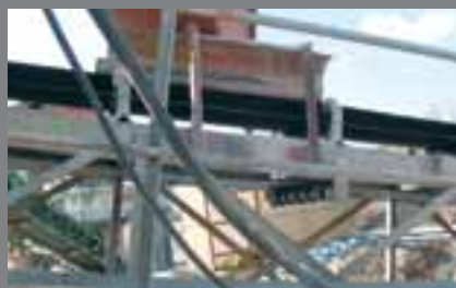
... an offenen, überbauten Untergurtrollen ...
