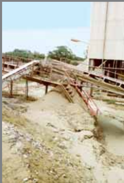
Dieser Zugang ist durch herabfallendes Material verschüttet und der Laufsteg durch ein später eingefügtes Förderband blockiert.
