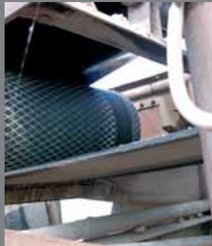
... an ungesicherten Umlenkstrommeln ...
