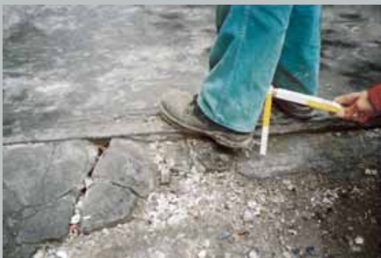
Eine Stolperfalle, wie sie im Buche steht. Eine Einbnung des Bodens käme Arbeitssicherheit und Knochen zugute.
