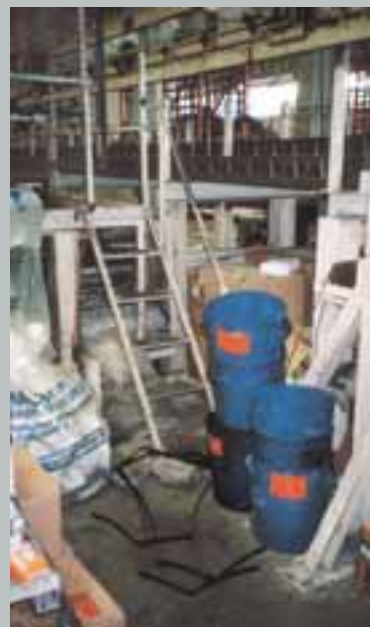
Hier muss unbedingt Platz geschaffen werden – denn von sicheren Verkehrswegen kann bei diesem Chaos keine Rede sein.
