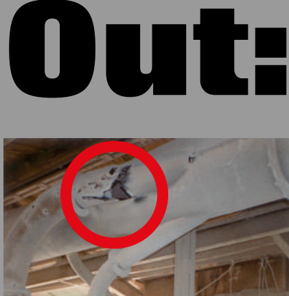
Voll durchgerostet! Dieses Rohr zieht Nebenluft und saugt nicht mehr richtig ab.
