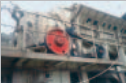
Die Schutzhaube, die oben an der Brechanlage fehlt...
