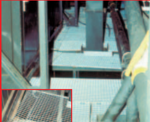
Arbeitsöffnung vor dem Schalt-Container mit den ungesicherten Rosten.
